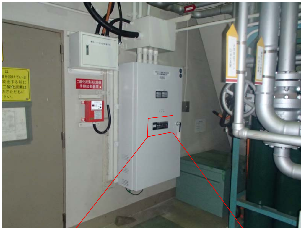
補助ボイラ建屋二酸化炭素消火設備制御盤の地絡警報
