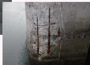
橋脚のコンクリートが剥離し鉄筋が露出
