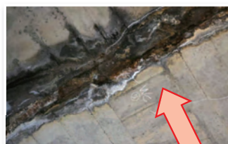
覆工コンクリートの剥離
