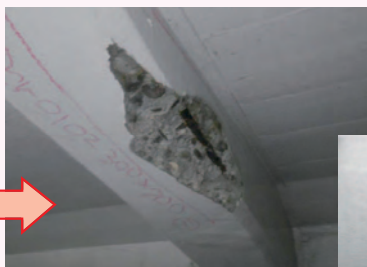
横桁のコンクリートが剥離し鉄筋が露出
