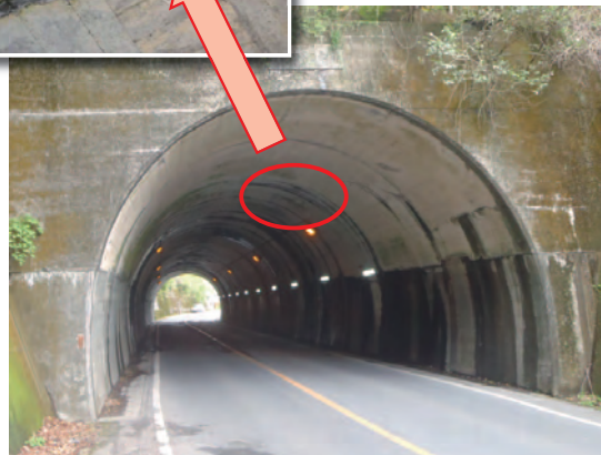
点検により確認された変状の例 佐伯蒲江線 池田トンネル（佐伯市）
