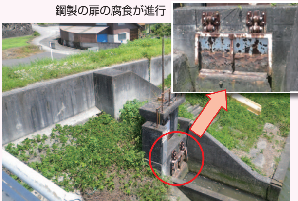
早期対策が必要な河川樋門（高山川 杵築市）
