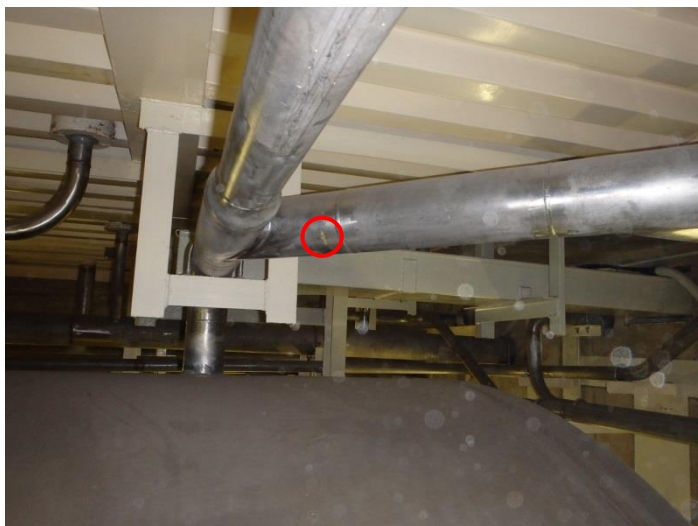
c. 廃液貯蔵タンク入口配管 (1箇所)
