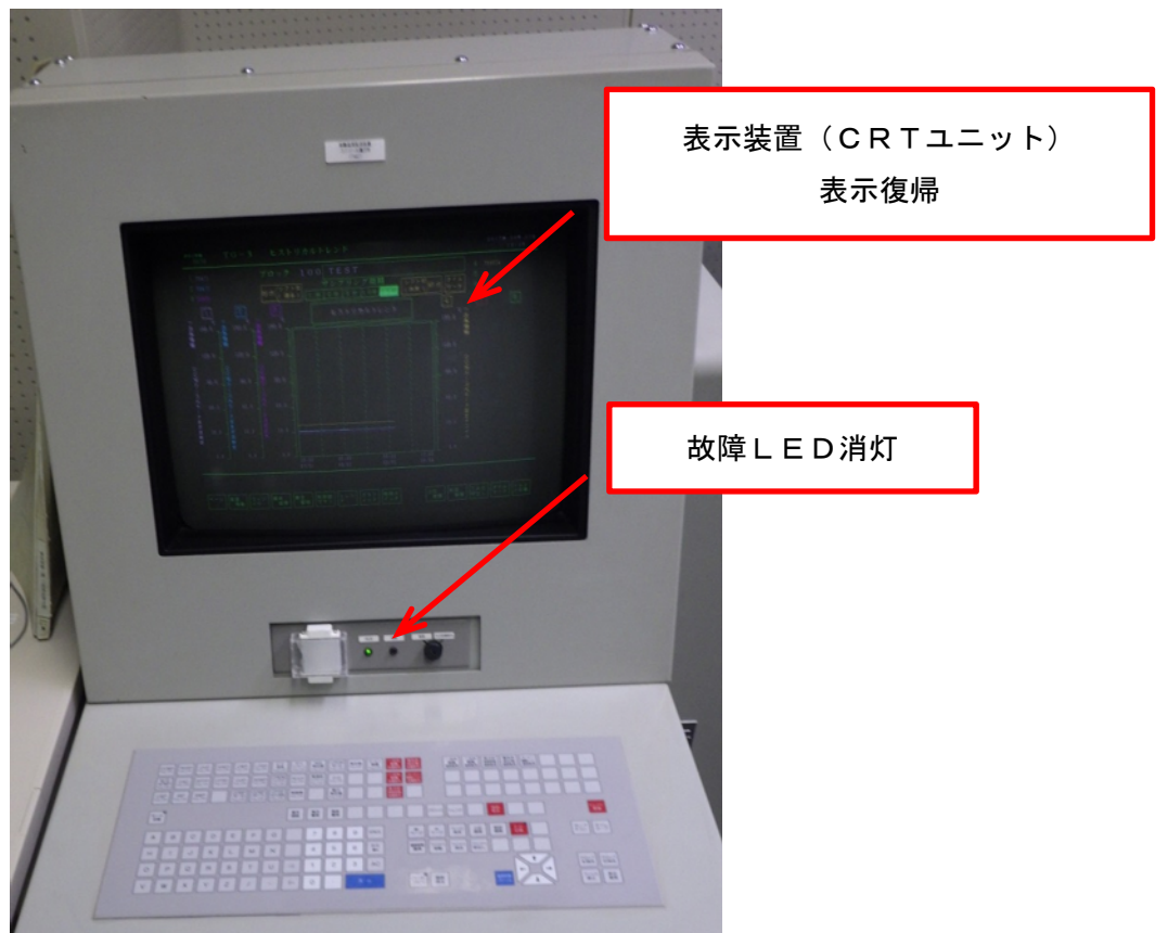
補機温度監視装置コンソール盤 (表示装置（CRTユニット）取替後)
