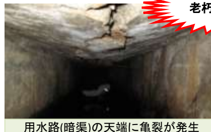
用水路(暗渠)の天端に亀裂が発生
