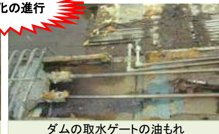
ダムの取水ゲートの油もれ
