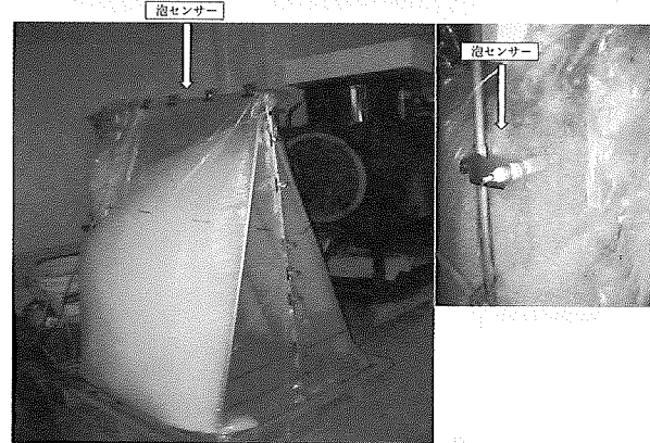
写真1 泡センサー付きハウスの泡沫注入状況
