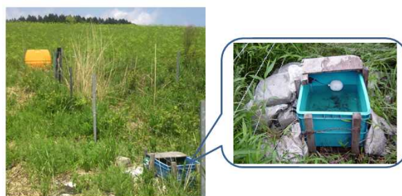
図2 高低差を利用した簡易給水設備
