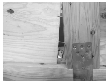
写真-10 釘の引き抜け
