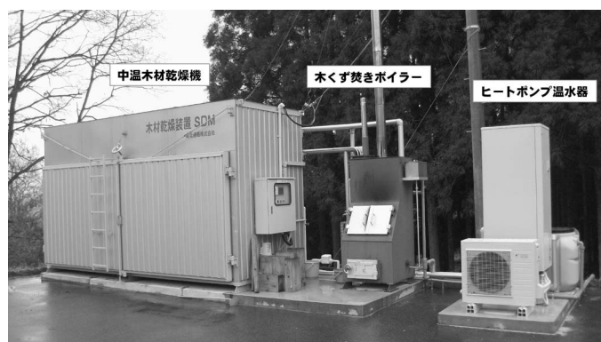
写真-1 温水式中温乾燥機の外観
