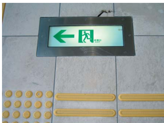
床面に設置した避難誘導灯 (iichiko 総合文化センター)
