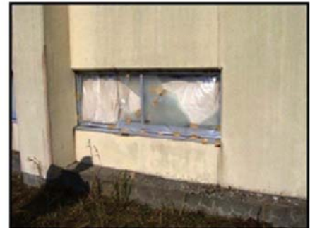
2011年2月2日 霧島市牧園町で空振により破損したガラス
