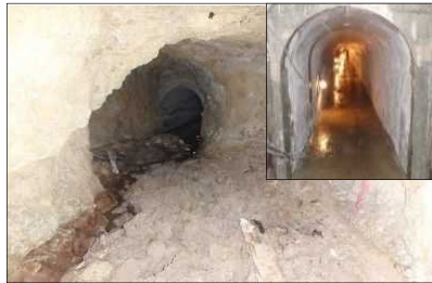
素掘りトンネルの洗掘・崩落
