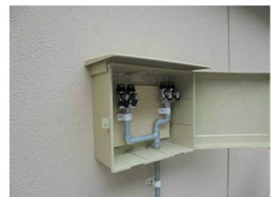
炊き出し用ガス配管
