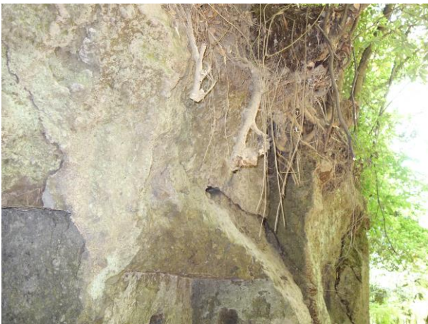
前面側の石窟上位側における崩落が懸念される土塊部（木根の繁茂で崩落を免れる）
