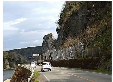
落石の恐れがあるのり面の対策 (国道502号：豊後大野市)
