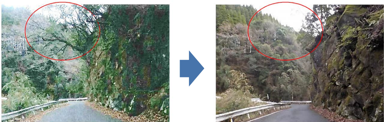
安全・安心な道路環境創出事業により法面に張り出した支障木を伐採 （緒方高千穂線：豊後大野市）
