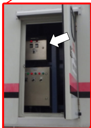
バッテリー充電器盤(矢印箇所)
