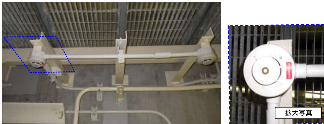
図2 火災感知器 設置状況 (取り替え後)
