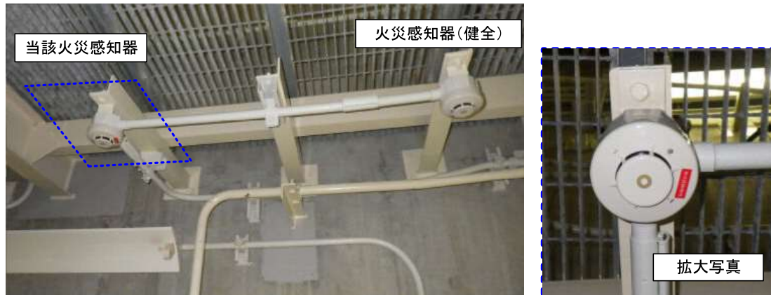
図1 火災感知器 設置状況 (取り替え前)
