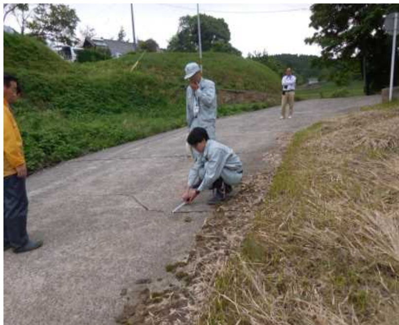
市道の亀裂(写真位置⑤)
