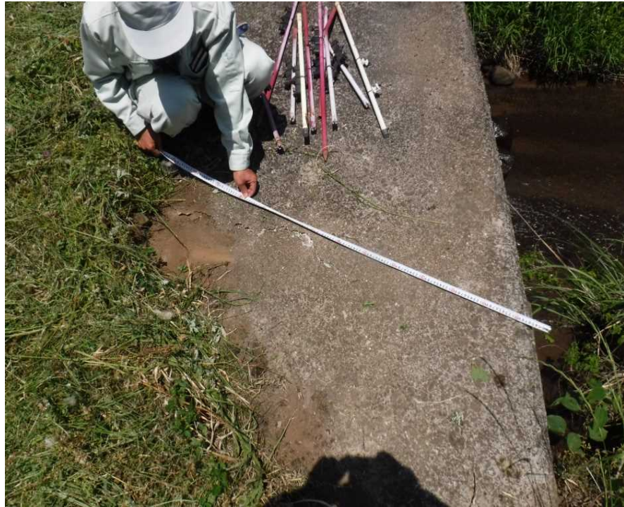
平井川床固工にクラック発生(写真位置⑦)
