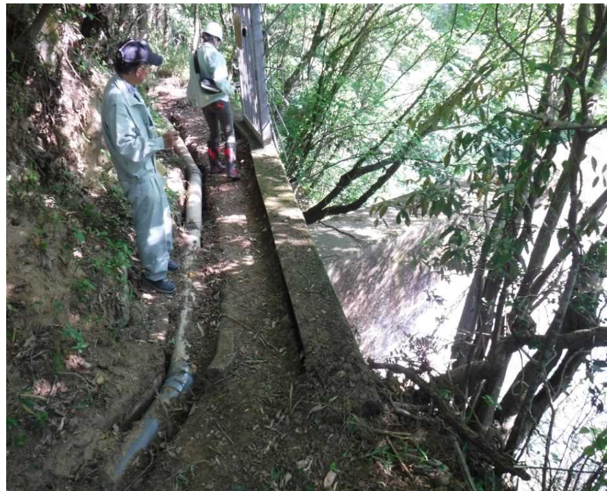
砂防堰堤左岸袖上部の間詰工に変状(写真位置⑧)
