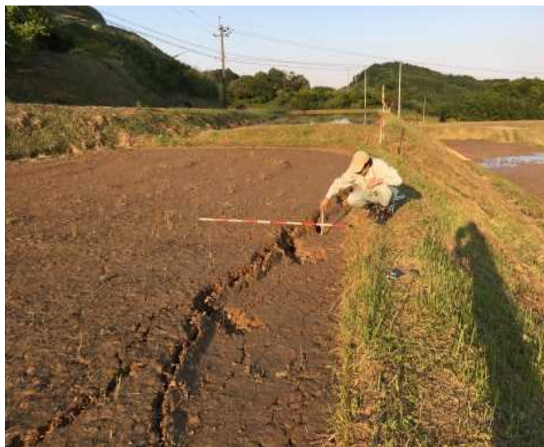
田に段差が発生(写真位置①)
