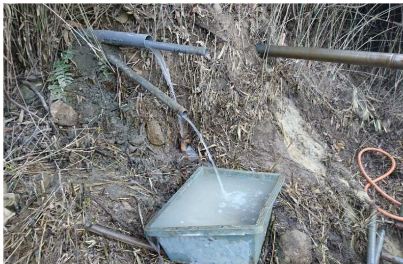
横ボーリングからの排水状況(写真位置④)
