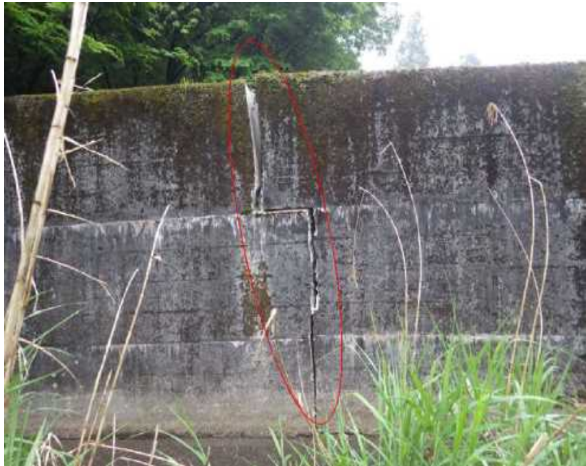
平井川砂防堰堤の左岸側袖部に入ったクラック 写真位置⑧
