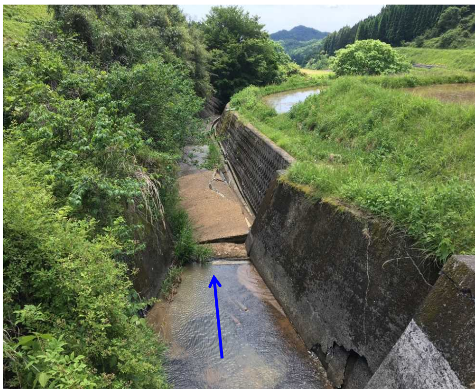
平井川変状(遠景)(写真位置⑦)
