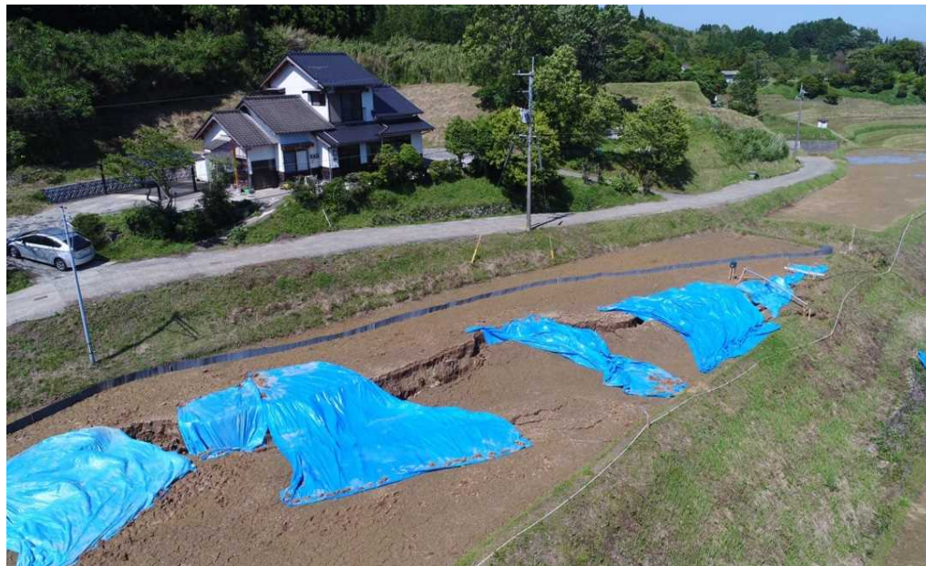
頭部の段差亀裂(写真位置①)
