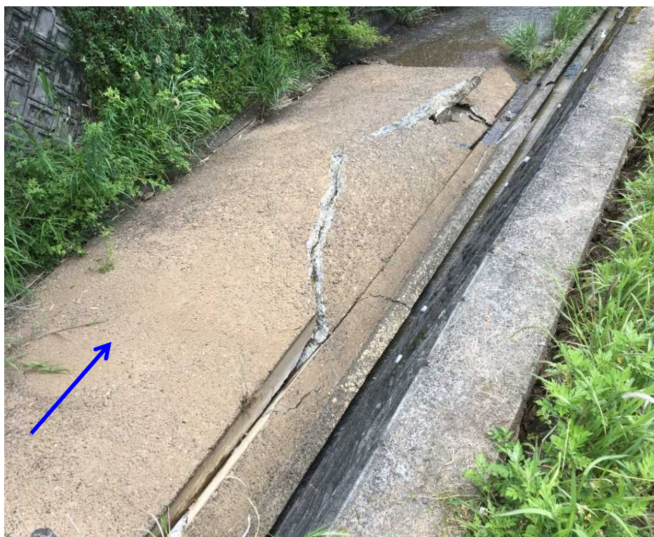
平井川変状(底版コンクリート近景)写真地位⑦)
