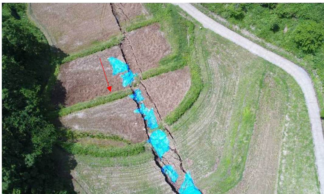
側方部のずれ(写真位置⑤)
