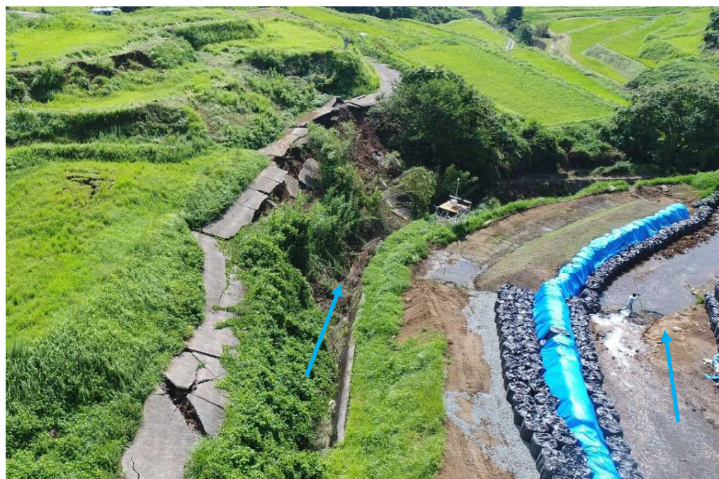
8月17日 末端部市道と平井川(写真位置⑦)
