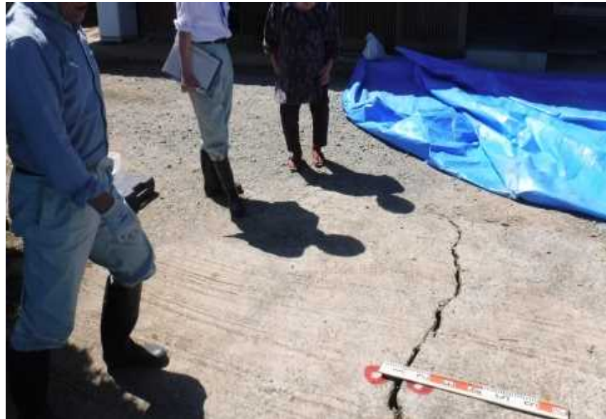
スケールによる亀裂幅の観測(写真位置④)
