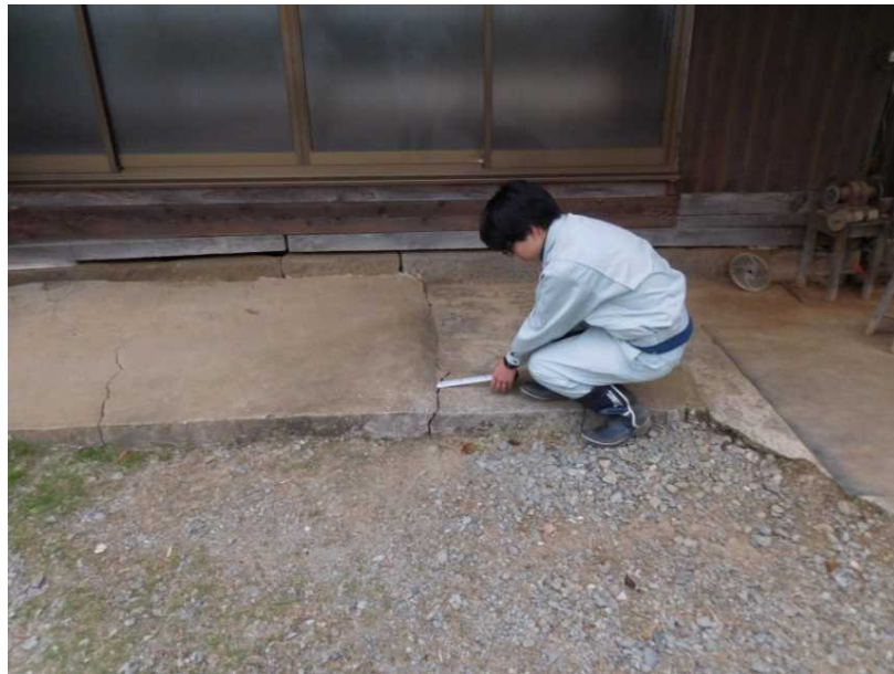
宅地内の亀裂(写真位置④)
