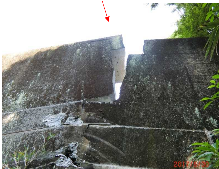
砂防堰堤左岸袖部の座屈破壊(写真位置⑧)
