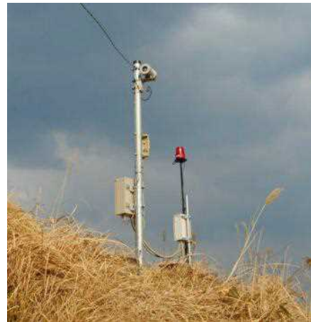
現場で警報を通知する赤色灯とサイレン
