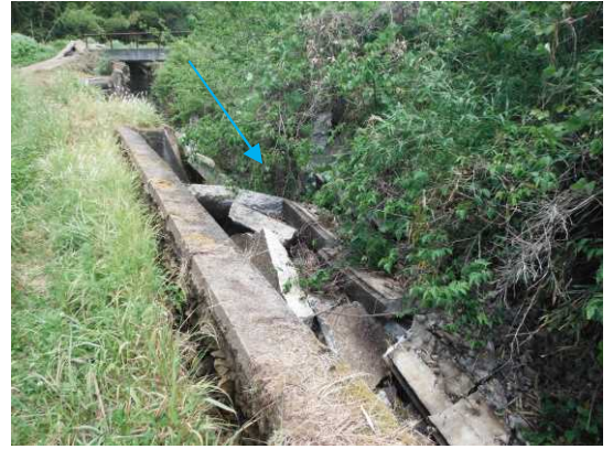
護岸ブロックの倒壊により閉塞した平井川
