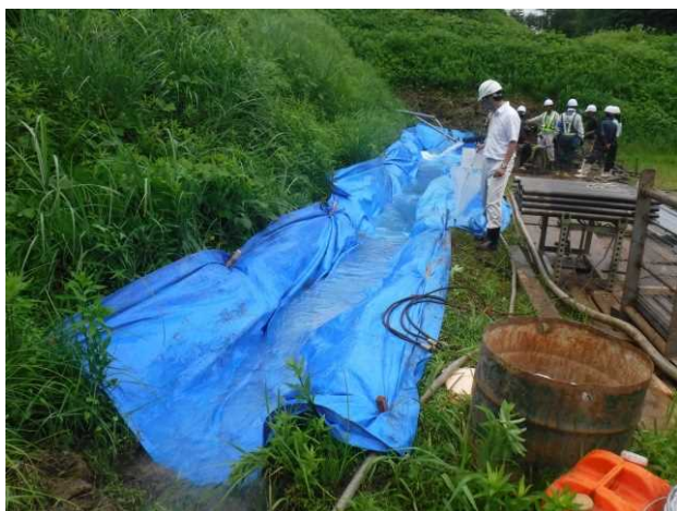
九州北部豪雨の際のブロック内の横ボーリングからの排水状況
