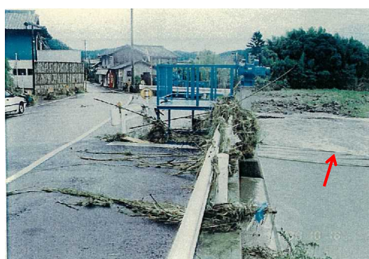
写真 2-2 平成 10 年 10 月出水の被災状況 (桂川：豊後高田市真中)
