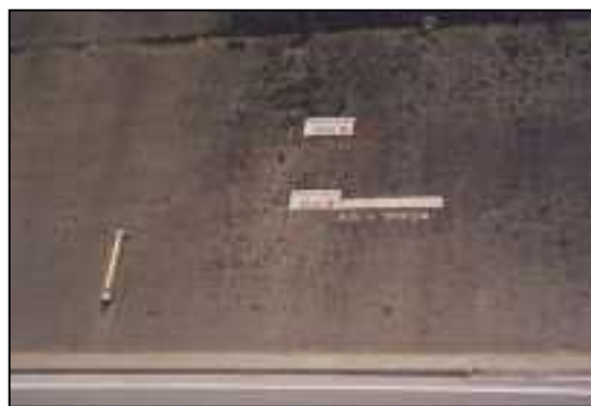
写真2-2（上）平成5年9月出水 （下）平成2年7月出水の痕跡水 （犬飼町：国道10号より）
