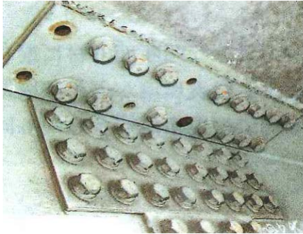
主桁連結部で複数のボルト脱落
