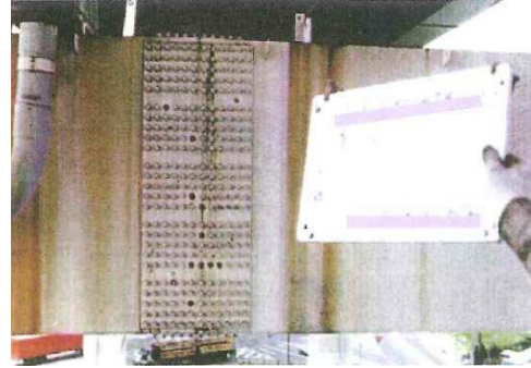
鋼製橋脚連結部で複数のボルト脱落
