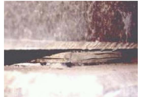
ゴムの劣化（ひびわれ）
