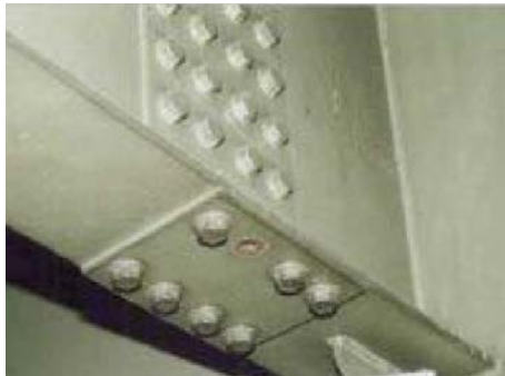
桁下が鉄道・道路など第三者被害の恐れがある箇所における F11T ボルトの脱落
