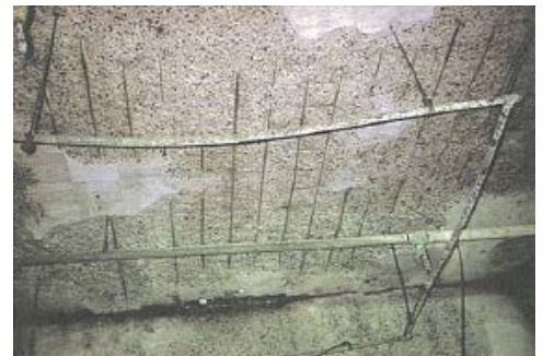
火害によるコンクリートの爆裂
