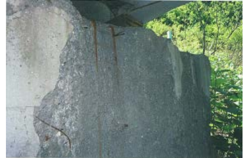
凍害によるコンクリートの劣化
