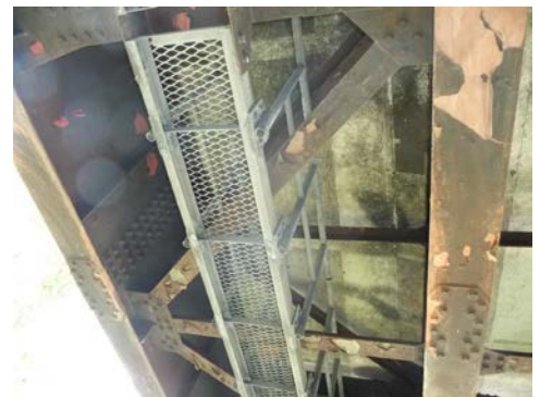
火害による塗装のはがれ
