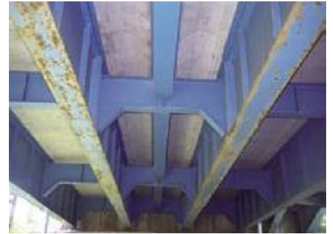
鋼材の防食機能の劣化・腐食
