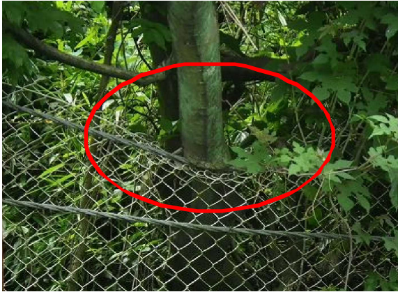
健全度Ⅱ 倒木によるワイヤーのたるみ
