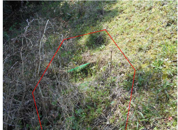
健全度Ⅲ のり面浸食
