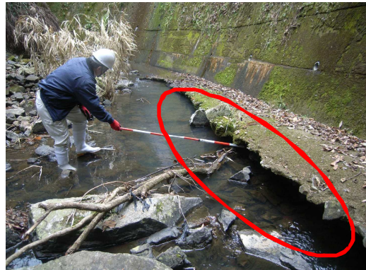
健全度Ⅲ 基礎部の洗掘
