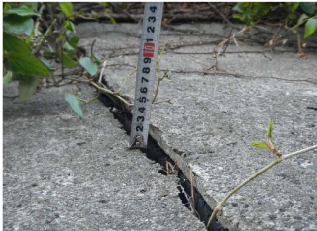
P4 中央付近 コンクリート擁壁目地状況(近景) (ズレW=20mm)
