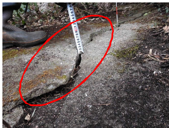
健全度Ⅲ 段差約 20mm
