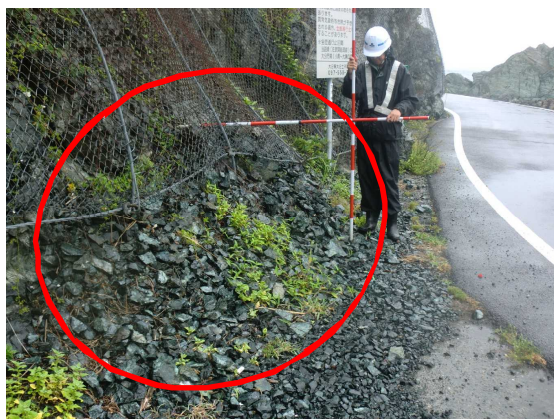
健全度Ⅱ 道路への土砂流出
