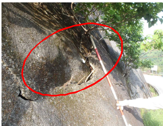
健全度Ⅱ 開口亀裂・はらみだし
