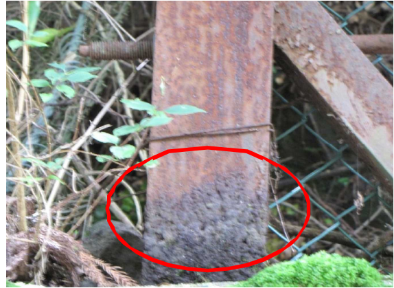
健全度Ⅲ 支柱部腐食
