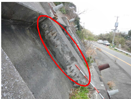
健全度Ⅱ 鉄筋露出
