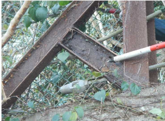
P3 起点側 落石防護柵状況(近景) (劣化による腐食(サビ)あり)
