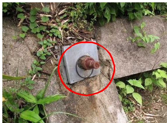
健全度Ⅲ 頭部キャップボトル欠損
