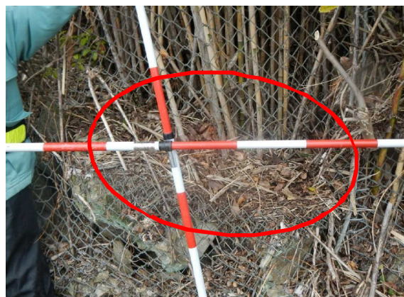
健全度Ⅲ 網の破れ
