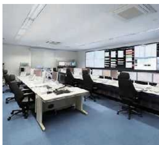
大分市消防局 通信指令センター
