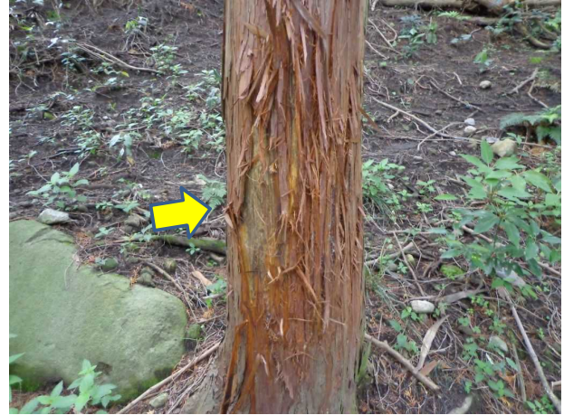
皮はぎ、角研ぎ被害を受けた ヒノキ
