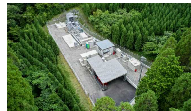
地熱発電の電力でグリーン水素を製造する実証プラント(九重町) 提供:(株)大林組
