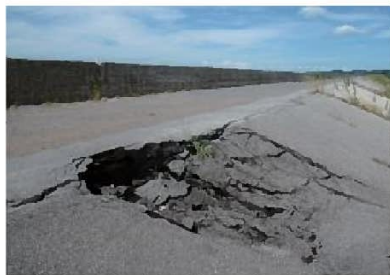
陥没した堤防
