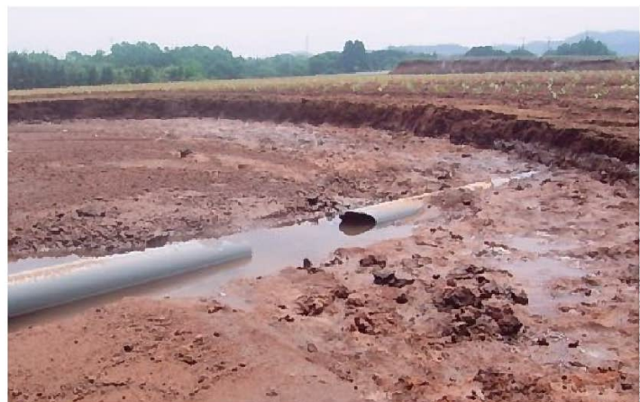
破損したパイプライン
