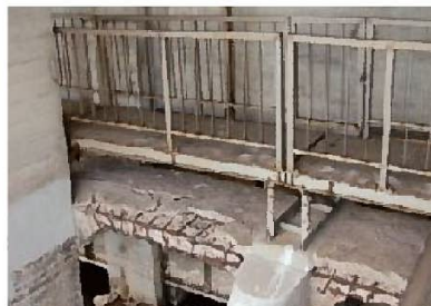
鉄筋が剥き出しとなった樋門
