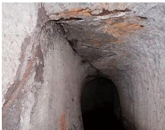
天端に亀裂が生じた水路トンネル
