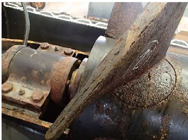
側面部に亀裂が生じた排水機場の羽根車
