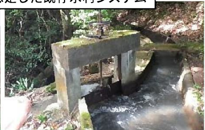
山間部の手動ゲート
