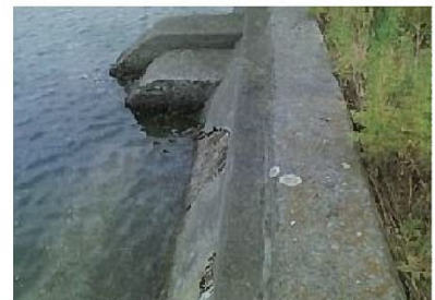
コンクリートが剥離した擁壁
