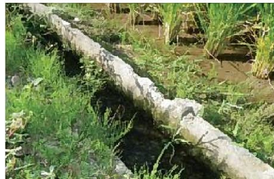
老朽化した末端用水路
