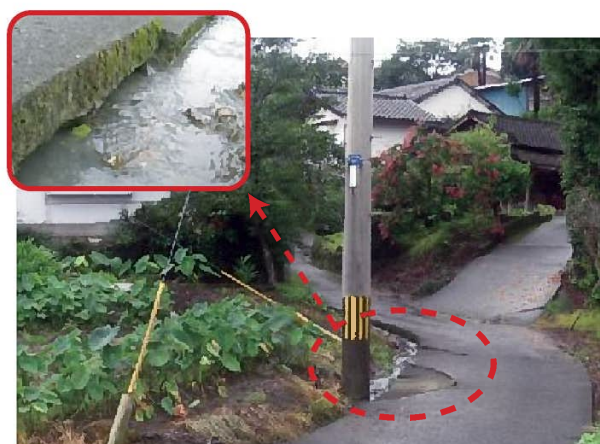
排水断面不足による道路の浸食・破損
