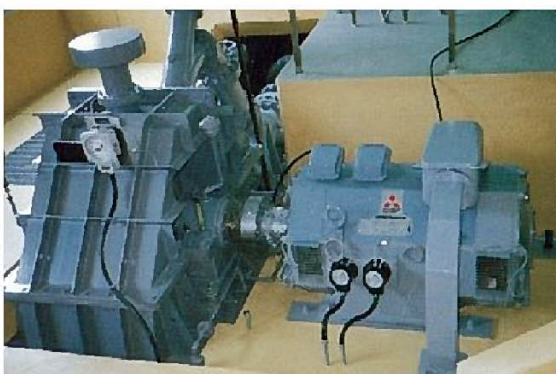
大野原発電所
