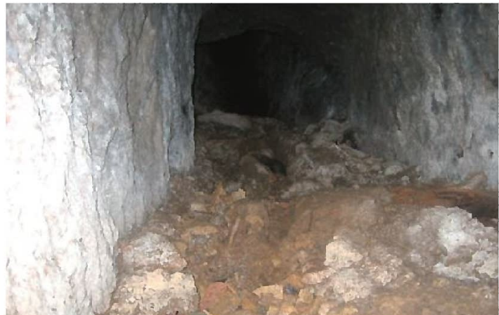
崩落により土砂が堆積した素掘水路トンネル
