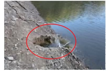
堤体からの水漏れ状況
