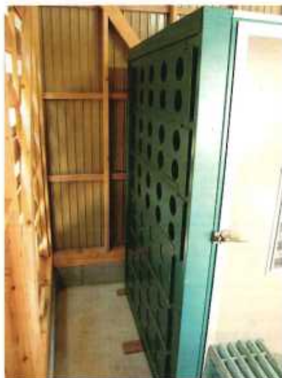
写真Ⅲ-2 排気口側の開口状態（初期設定）：6段12列の排気口のうち上部から3段6列を開放
