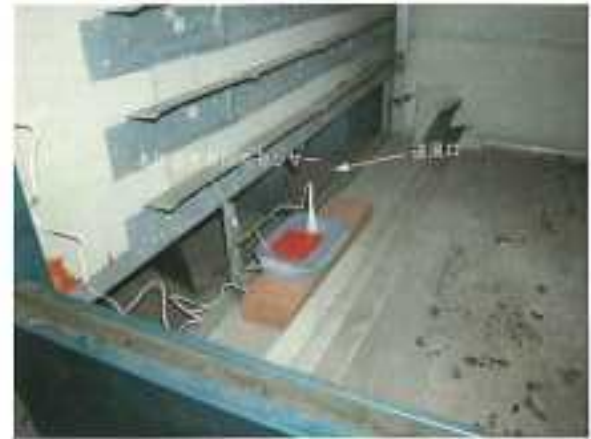
写真IV-2 垂直気流式における設置事例
