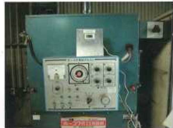
写真IV-4 湿球温度表示部の設置事例 (制御盤上部)
