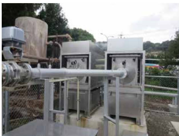
湯けむり発電システム（別府市）
