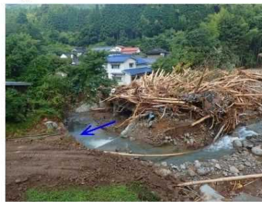
③ 橋梁(中崎橋)流木阻害状況
