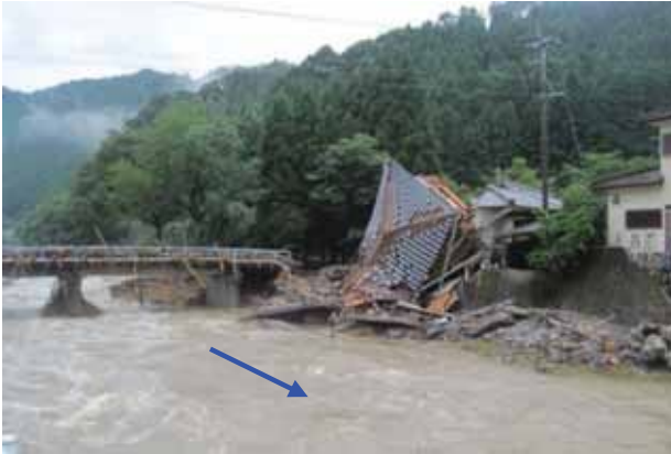
花月川被災状況(日田市大字花月)
