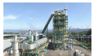
木質バイオマス発電所(日田市)
