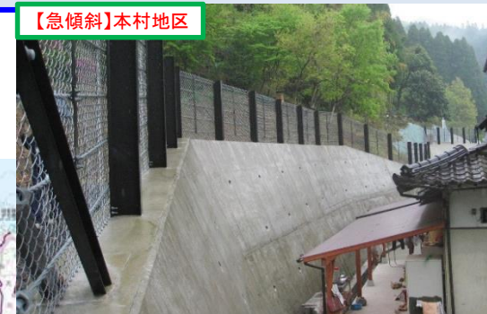
令和3年度の取組 急傾斜地崩壊防止施設の整備
