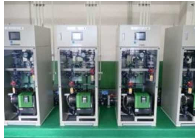
薬品注入ポンプ
