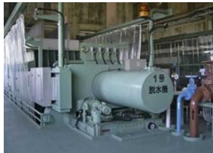
加圧脱水機(汚泥処理設備)
