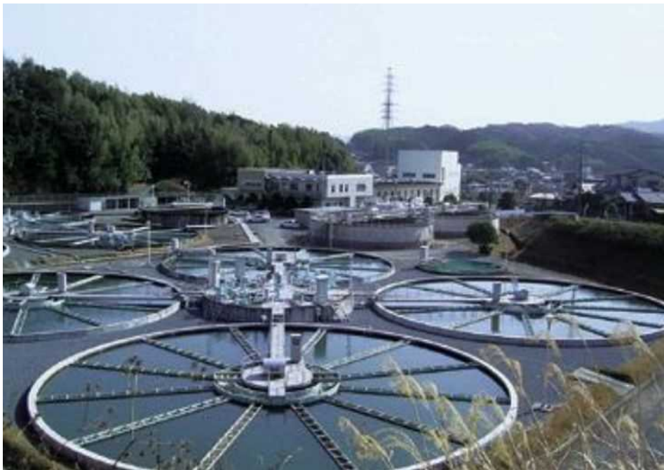
判田浄水場（大分市）
